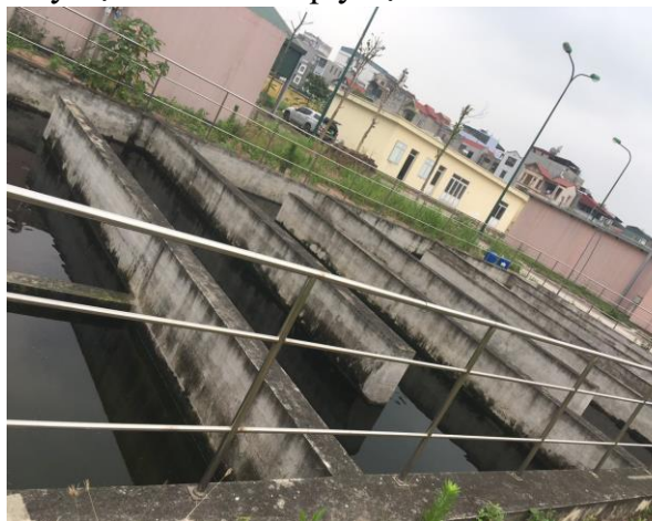
Hình 3.16: Bể khử trùng
