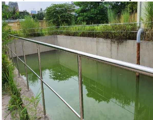
Hình 3.17: Bể chứa nước thải sau xử lý
