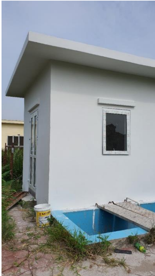
Hình 3.19: Nhà đặt trạm quan trắc nước thải tự động, liên tục
