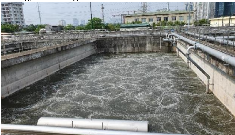
Hình 3.15: Bể SBR cải tiến
